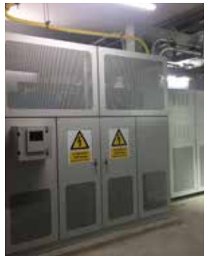
หม้อแปลงไฟฟ้า
