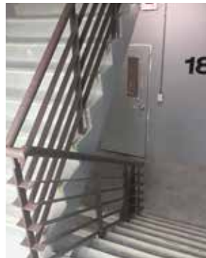
บันไดหนีไฟ
